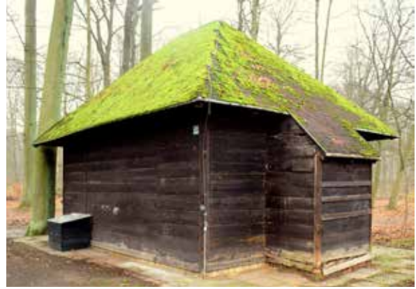
Zachowany budynek lodowni, w którym na lodzie, rąbanym na stawie widocznym z tyłu, przechowywano produkty żywnościowe, z uwagi na stan budynek przewidziany jest do rozbiórki, fot. Henryk Leśniak
